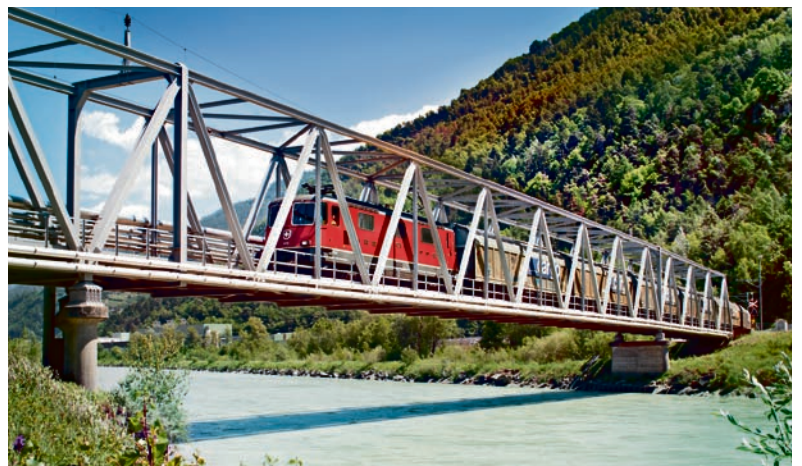
Drei- bis viermal pro Tag rollen beladene Güterzüge über die Brücke, die Aproz vor 50 Jahren über die Rhone bauen liess.
